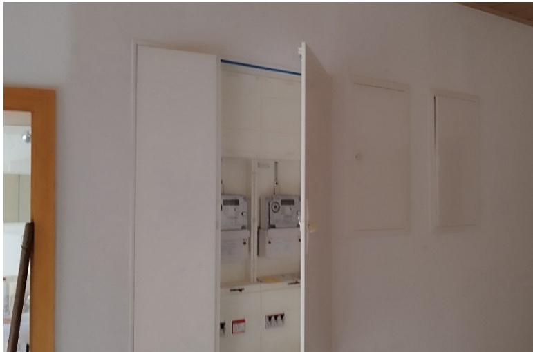
Zählerkasten in Flur West EG
